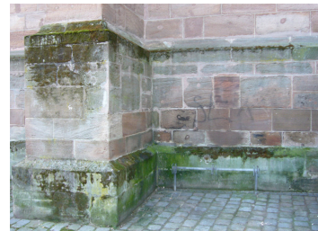
Bild 11: Algenablagerung auf Sandsteinsockel
