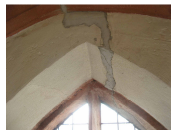
Bild 1: Riss über einem Fenster
