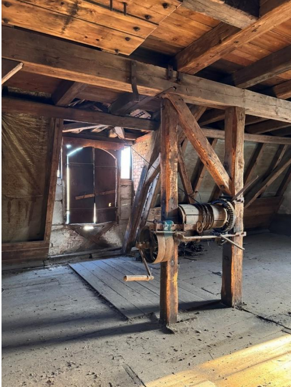
Abb. 67 – Seilwinde für den Aufzugserker
