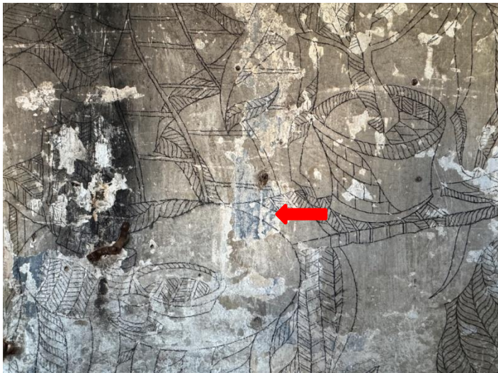
Abb. 37 - Haupthalle 01, Westwand a, Farbfassungsreste, um 1895 (Pfeil).
