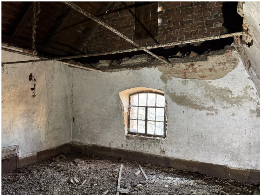
Abb. 71 – Südwestlicher Darrraum mit fehlendem Gewölbeabschluss und freiliegenden Zugstangen.
